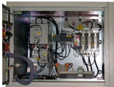
Dettaglio cassetto avviatore diretto per pompa di raffreddamento: 440V-52kW-87A
