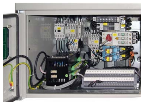
Dettaglio cassetto avviatore 2 velocità per pompa delle acque di sentina: 440V-3kW-6A
