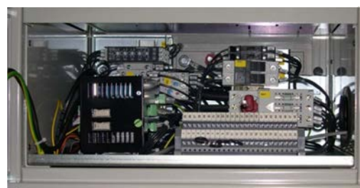
Dettaglio cassetto avviatore diretto per pompa acque sanitarie: 440V-6kW-12A
